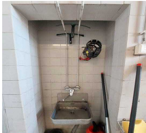
Tasapohja-allas ja aputilahana pesuhallissa.
