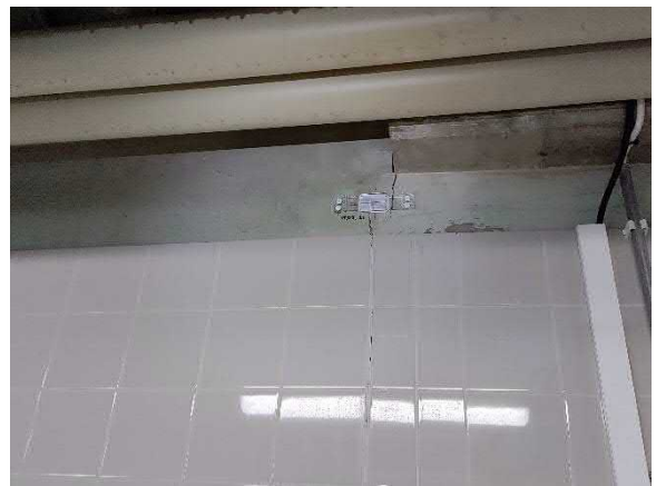
Kantavassa väliseinässä halkeama
