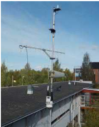
Antenneja vesikatolla yhteismastossa
