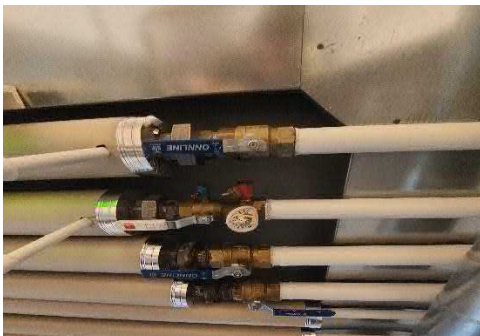
Alkuperäiset sulku- ja linjasäätöventtiilit.
