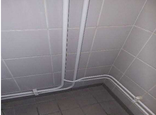
Kupariset kytkentäjohdot wc-tiloissa.
