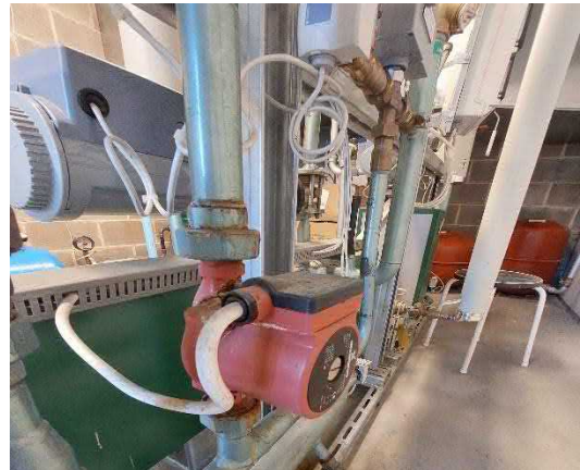
Alkuperäinen kiertopumppu, liitoksissa korroosiota.
