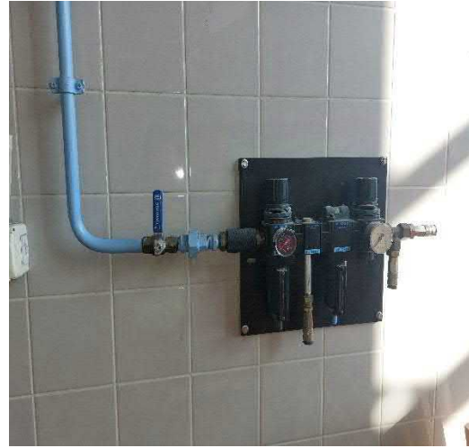
Ns. normaalipaineilmajärjestelmän paineensäädin.
