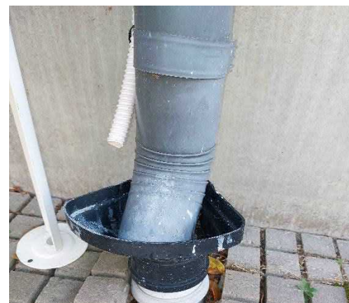
Kattosadevedet johdettuna rännikaivoon.
