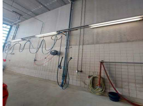
Muovinen sadevesiviemäri pesuhallissa.
