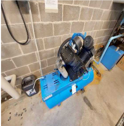
Ns. normaalipaineilmajärjestelmän paineilma-kompressorin.
