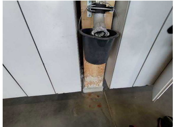
Puupilarin alaosaassa kosteusjälkiä
