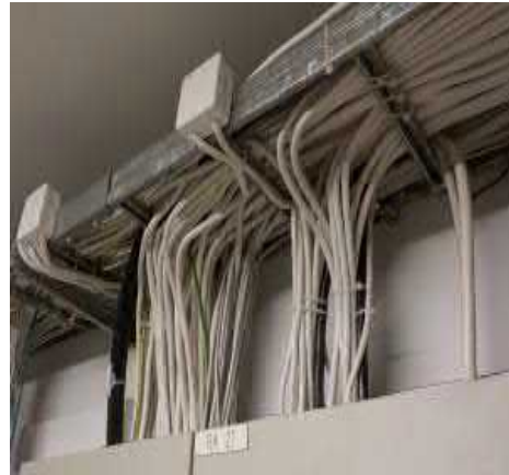
Johtoreitti täynnä kaapelia keskuksen yläpuolella
