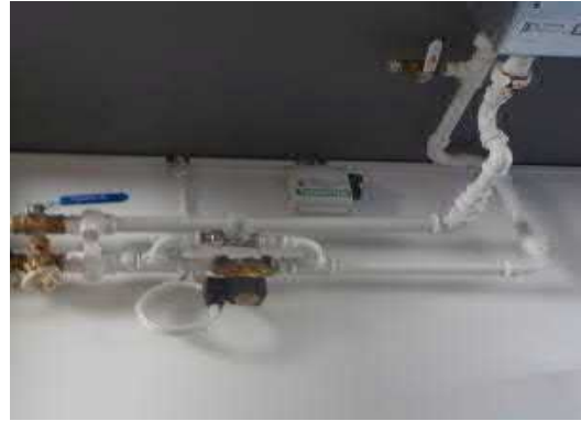
Kiertoilmakojeen sähköistystä tuulikaapissa
