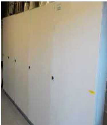
Pääkeskus teknisessä tilassa
