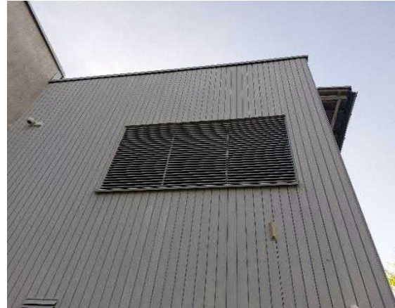
TK02 tuloilmakoneen raitisilmasäleikkö.
