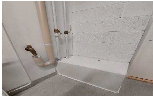
Lattialämmityksen jakotukit suojakotelossa.
