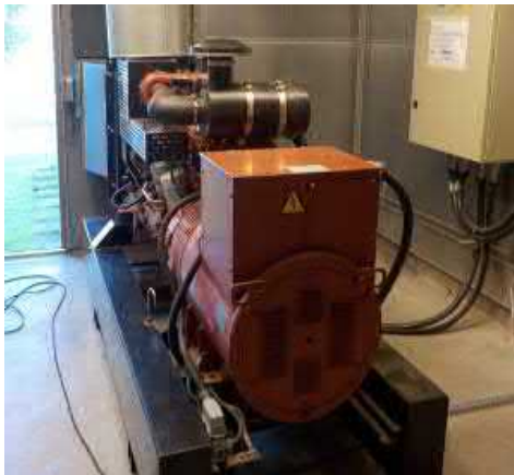
Varavoimalaitteisto teknisessä tilassa
