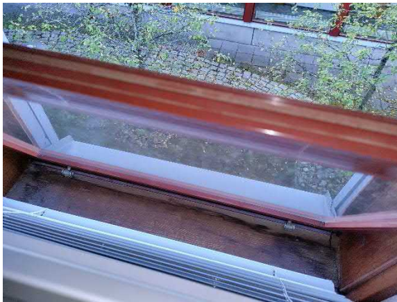
Ikkunakarmin alaosassa kosteusjälkiä
