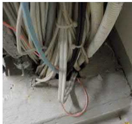
Läpivienti teknisessä tilassa
