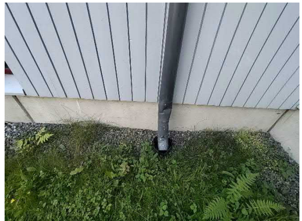
Sadeveden syöksytorvessa lommo
