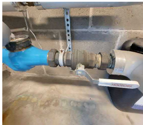
Vesimittarin alkuperäinen sulkuventtiili.
