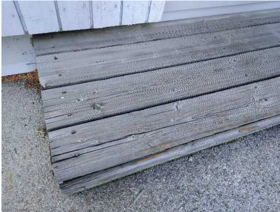
VSS:n kattotasanteen oven porras on huonokuntoinen
