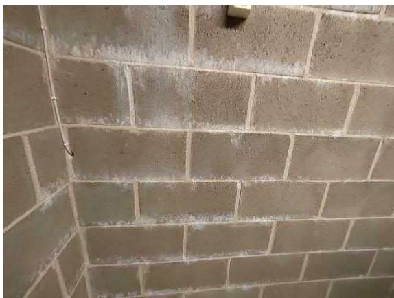
Harkkoseinässä mahdollisesti rakennusaikaisia muurauslaastin jälkiä
