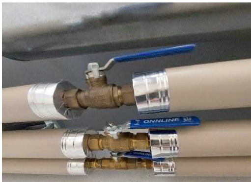
Käyttövesiverkoston alkuperäiset sulkuventtiilit.
